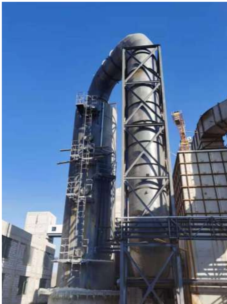
供热锅炉超低排放
