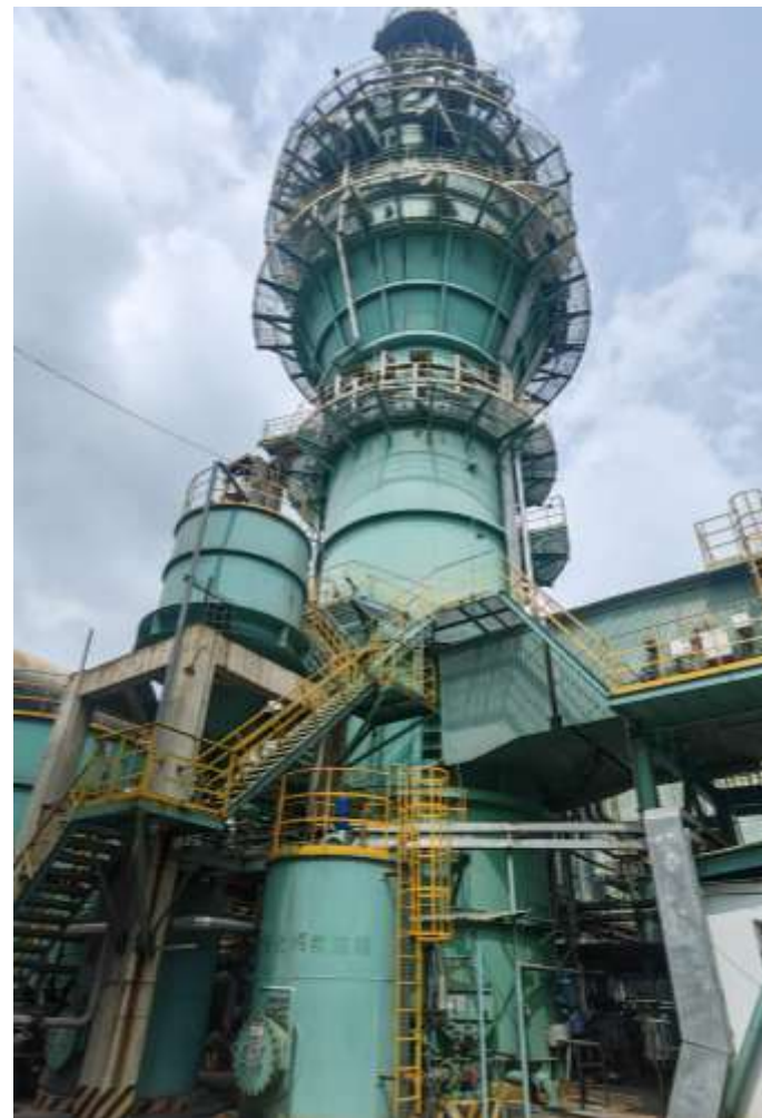
高炉煤气热电锅炉脱硫脱硝
