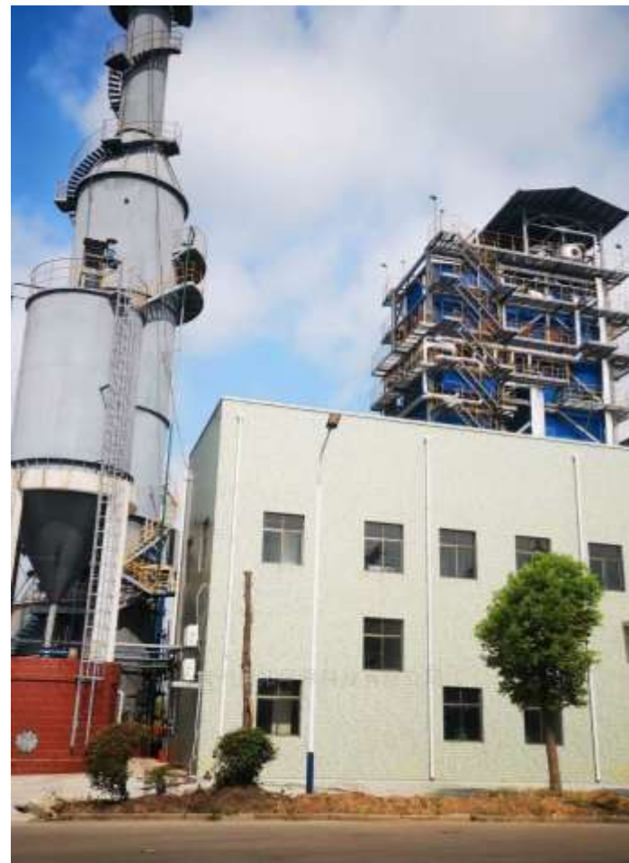
生物质锅炉超低排放
