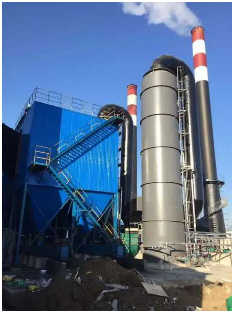
燃煤锅炉超低排放
