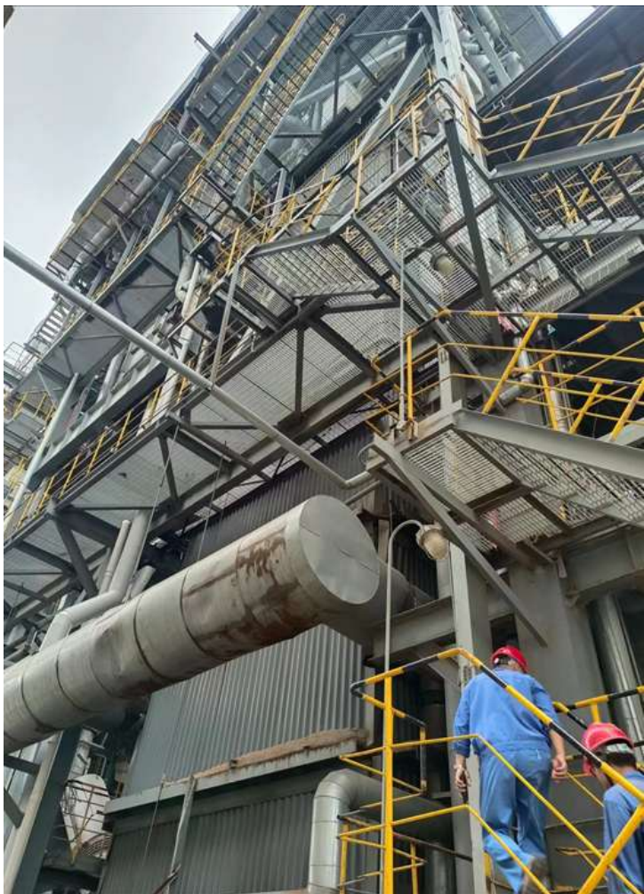
20t/h生物质链条锅炉脱硝
