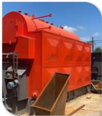
生物质锅炉脱硝
