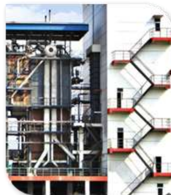
流化床锅炉脱硝
